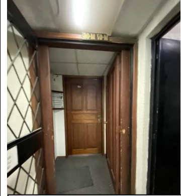
Obstaculización ante una posible emergencia.
