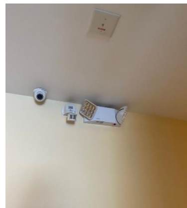
Verificación de las lámparas de emergencia
