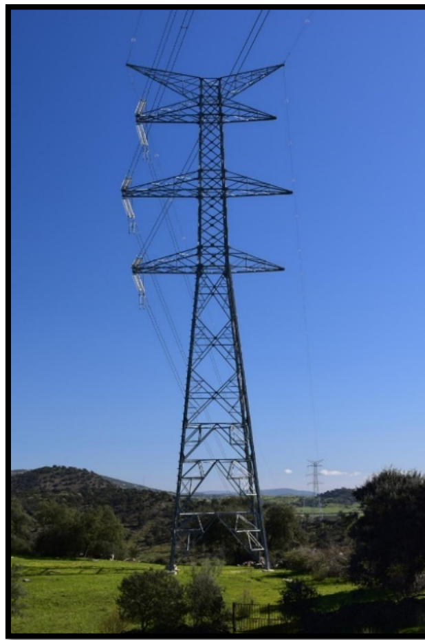
Ilustración 3. Torre de anclaje angular
