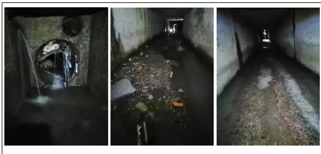
Figura 45. Colector cuadrado ingresa tubería existe taponamiento y filtraciones de agua. Fuente: Elaboración propia.
