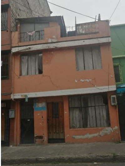
FOTO No.1 Agrietamientos de consideración en paredes exteriores foto tomada 2021.
