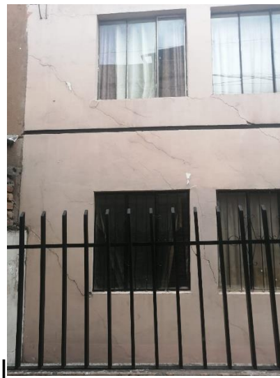
FOTO No.4 Agrietamientos de consideración en paredes exteriores de varias viviendas
