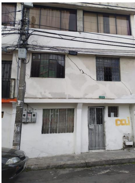
Figura 11. Grieta Longitudinal en la Mampostería. Fuente: Elaboración Propia.
