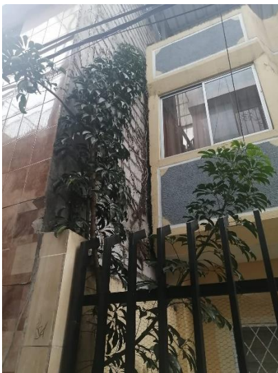
FOTO No.3 Asentamiento e inclinación de las viviendas
