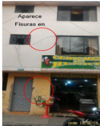
FOTO No.8 Agrietamiento e inclinación de vivienda en calle José Belda
