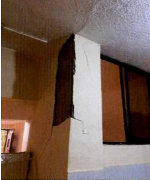
FOTO No.3 Falla por cortante en cabeza de columna.
