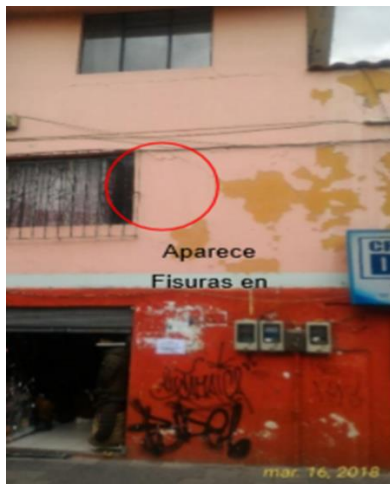
FOTO No.11 Agrietamiento e inclinación de vivienda foto tomada 2018
