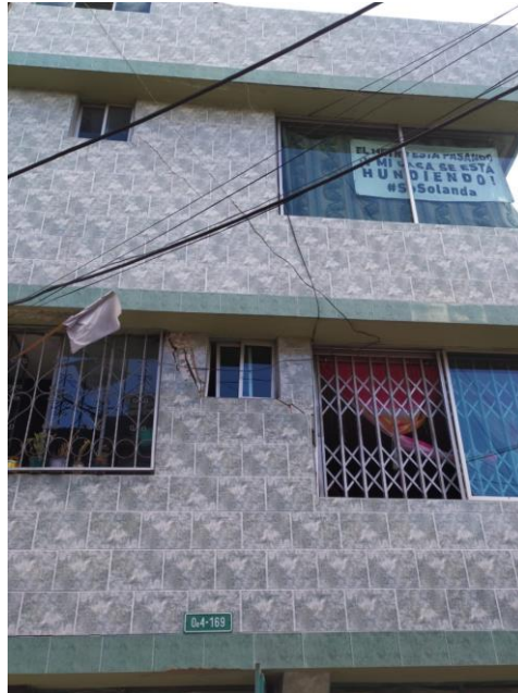
Figura 12. Fisuras en la Mampostería. Fuente: Elaboración Propia.
