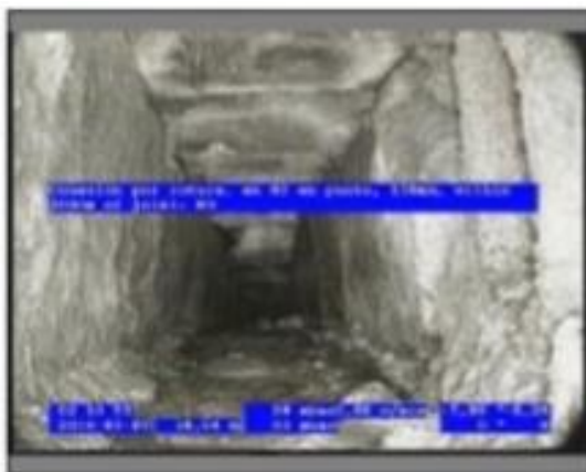
Foto: 6_10A 39,02m, Conexión por rotura, en O2 en punto, 150mm, within 200mm of joint: NO / Ninguna, dentro de los parámetros admisibles
