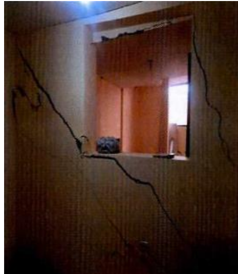
FOTO No.2 Agrietamientos de consideración en paredes interiores.
