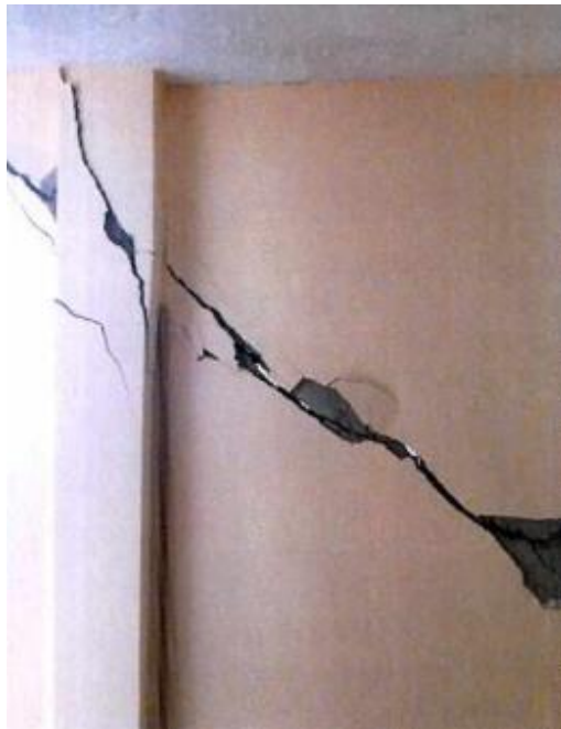
FOTO No.5 Falla por cortante en cabeza de columna y agrietamientos de consideración en paredes interiores.
