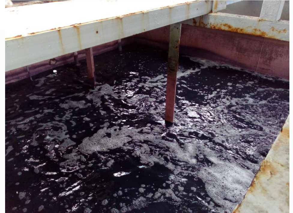
Tratamiento biológico en la PTAR
