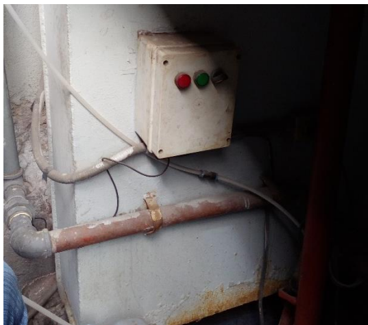
Figura 9. Panel de accionamiento de la bomba de alimentación al reactor biológico
