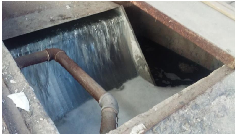
Figura 3. Ingreso del agua del proceso de tinturado, a la cisterna.
