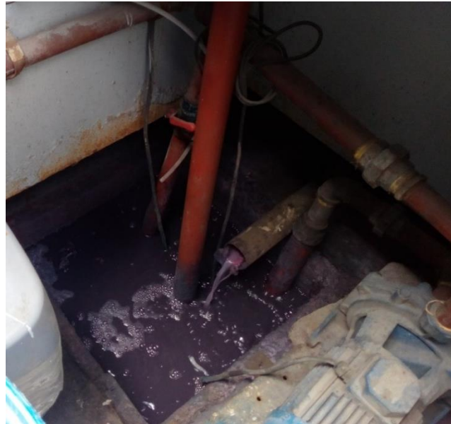
Figura 4. Ingreso del agua del proceso de desgrabado de marcos de serigrafía, a la cisterna.
