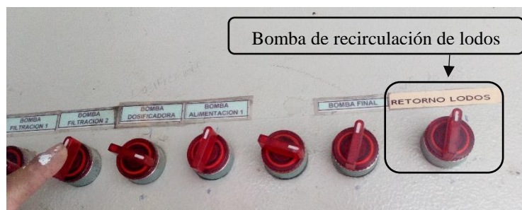
Figura 11. Panel de control general - perilla para encender la bomba de alimentación al reactor biológico
