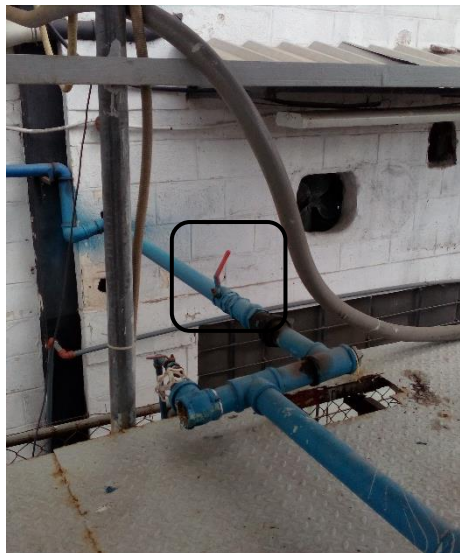
Figura 6. Activación y regulación de flujo de aire en la cisterna
