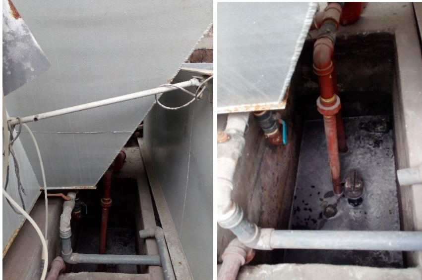
Figura 12. Sedimentador - purga de lodos
