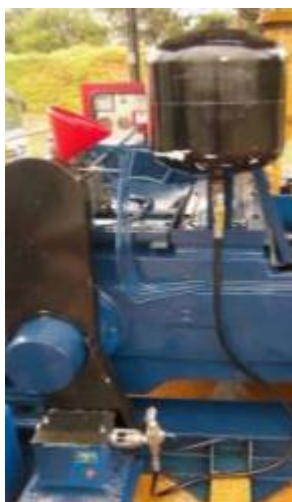
Figura 9. Bomba de inyección de químicos
