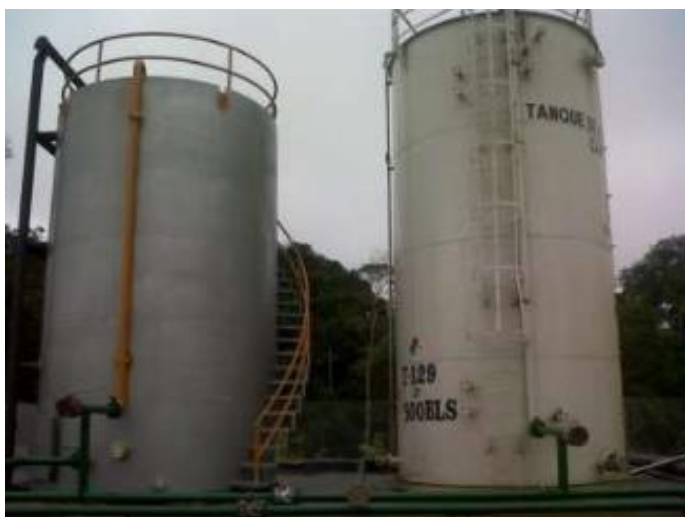
Figura 13 Tanque de almacenamiento Fuente: (SERTECPET, 2013, pág. 44)
