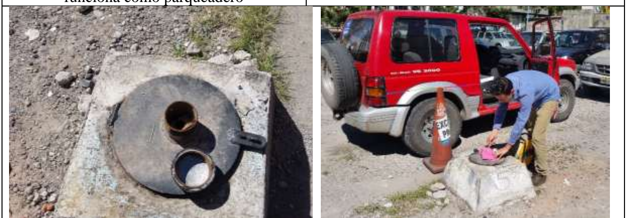
Fotografía 3: Instalaciones pozo 5P
