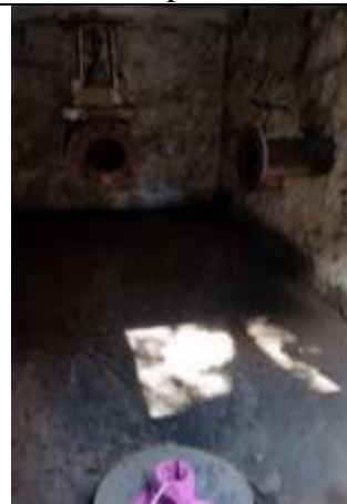
Fotografía 4: Instalaciones pozo 12A
