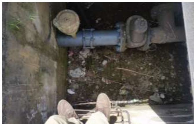
Fotografía 3: Presencia de basura y desperdicios dentro de las instalaciones del pozo
