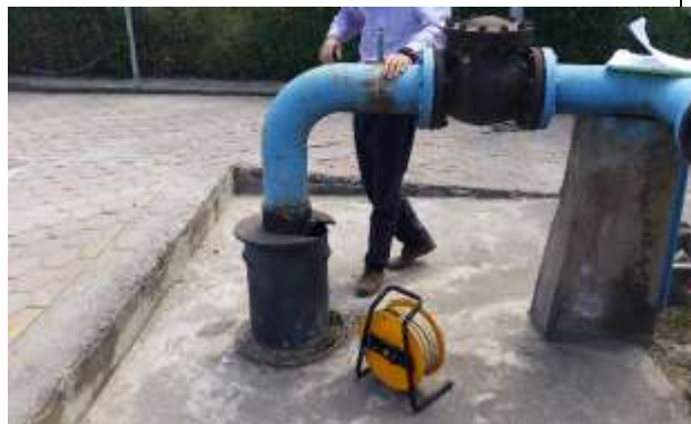
Fotografía 1: Instalaciones pozo Planta de Tratamiento
