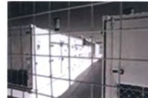
Área de generadores
