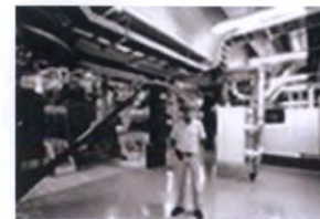
Área de Aire acondicionado
