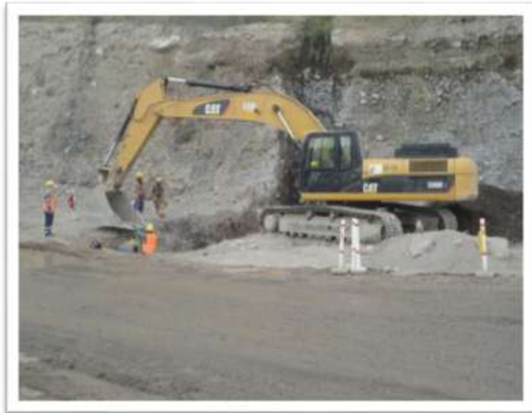
Figura 18. Golpes con maquinaria, y personal que se encuentra laborando
